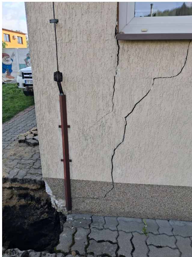
Fot. 2. Spękanie ściany północno - zachodniej
