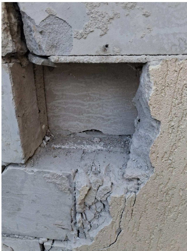
Fot. 7. Skuta ściana budynku od strony zachodniej
